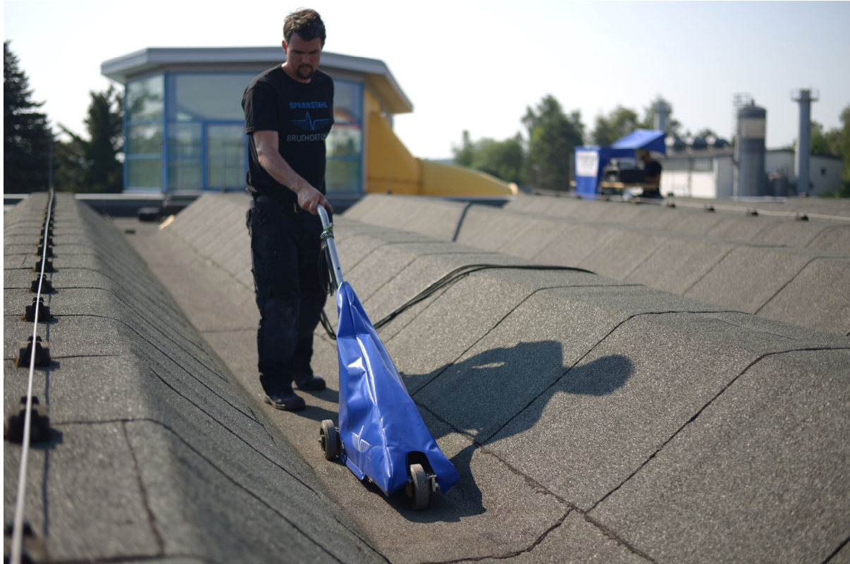
Bild 6: Untersuchung von VT-Falten einer Schwimmhalle.
